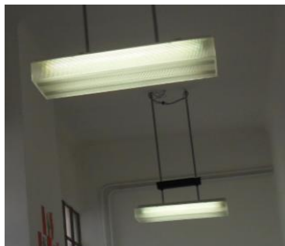
Figura 4.12 - Particolare dei corpi illuminanti ubicati nel corridoio
