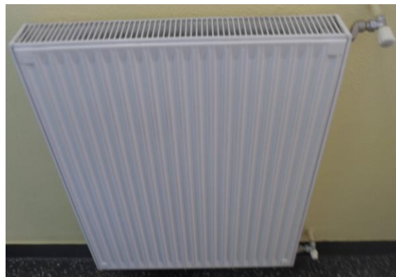
Figura 4.6 - Particolare del radiatore presente nell'edificio
