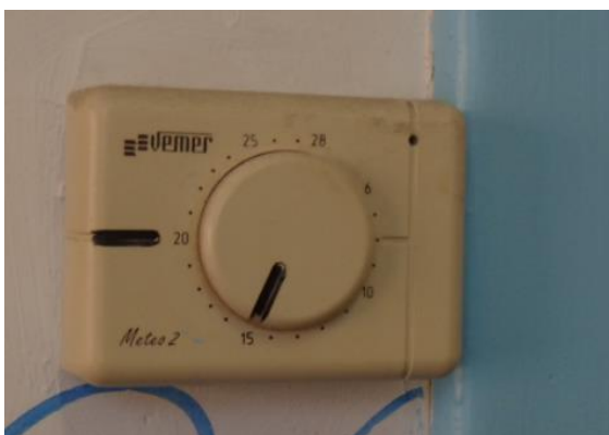
Figura 4.7 - Particolare termostato presente in un'aula (non funzionante)
