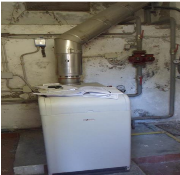
Figura 4.10 - Particolare del generatore
